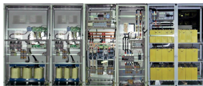
Рис. 3. Внешний вид литий-ионной АБ 380 А-ч (тип LT-LYP 380–70 шт.) в составе СПТ 220 В Fig. 3. Configuration of lithium ion accumulator battery 380 A-h (type LT-LYP 380–70 pieces) as part of 220 V DC system
