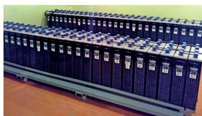
Рис. 1. Внешний вид свинцово-кислотной аккумуляторной батареи напряжением 220 В Fig. 1. Configuration of 220 V lead-acid accumulator battery
